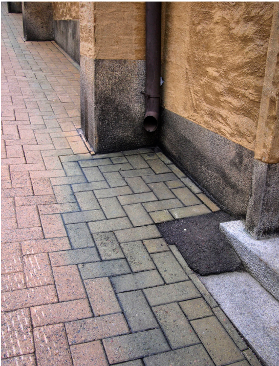
Kuva 30. Helsingin Etu-Töölössä sijaitsevan Olaus Petrin kirkon kuparipellityksen valumajälkiä jalkakäytävällä. Kuvattu 26.4.2013.
